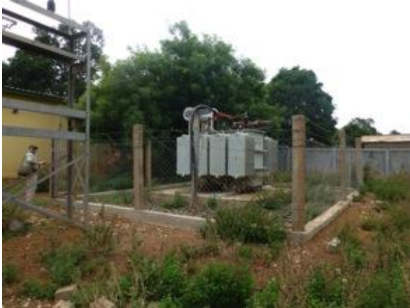
Poste 30/7 kV existant de Kankan.
