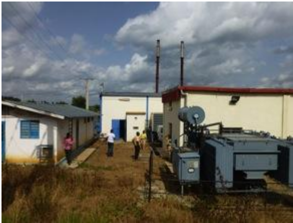
Centrale et poste électrique de N'Zérékoré.
