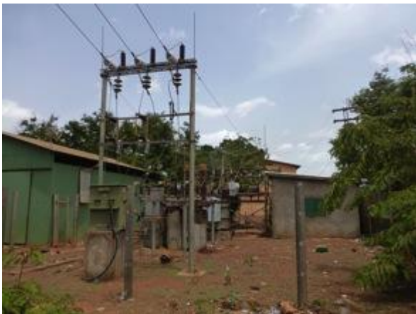
Poste 30/7 kV de Siguiiri. Au milieu de la photo le support de raccordement à 30 kV.
